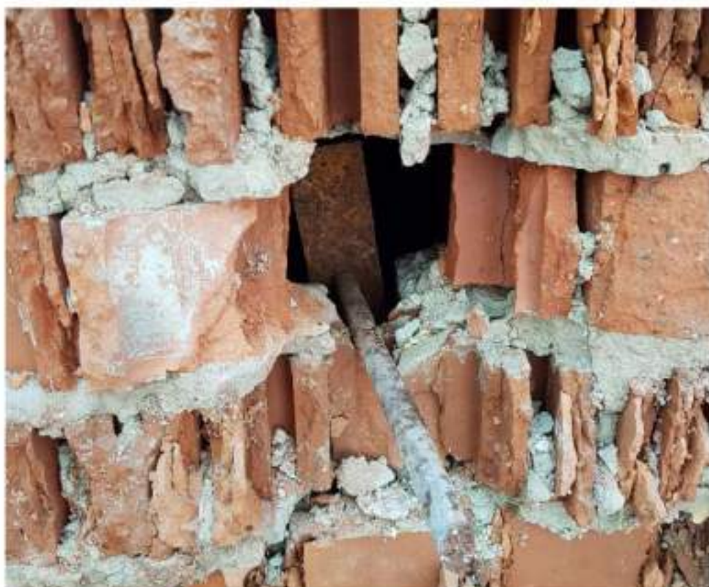
Фото 6. Сквозной пролом кирпичной кладки стены. Закладная деталь
