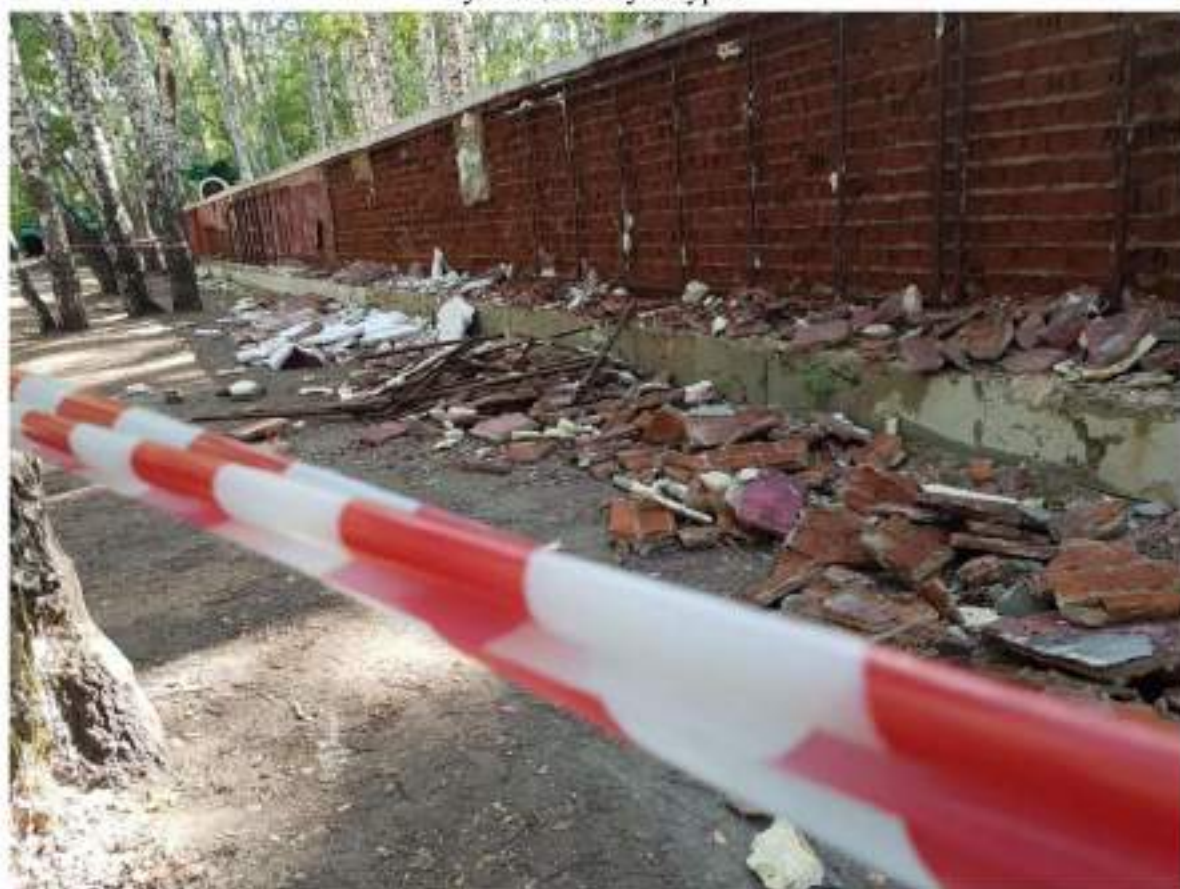
Фото 2. Отхождение лицевого слоя кирпича вместе с бухтящей штукатуркой.
