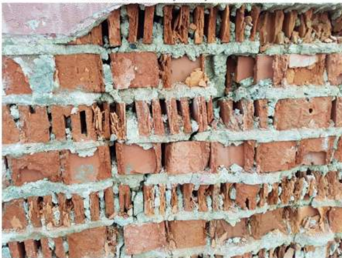
Фото 4. Повсеместное состояние кирпичной кладки. Деструкция кирпича
