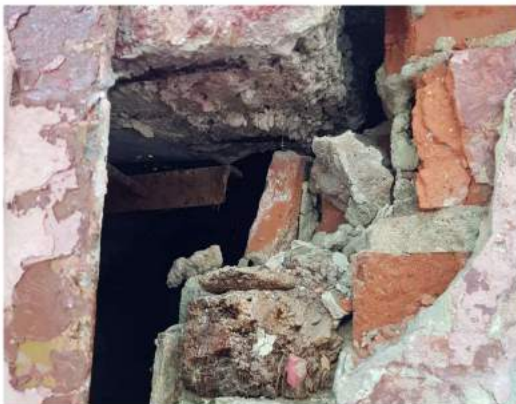
Фото 5. Разрушение опирания перемычки дверного проёма
