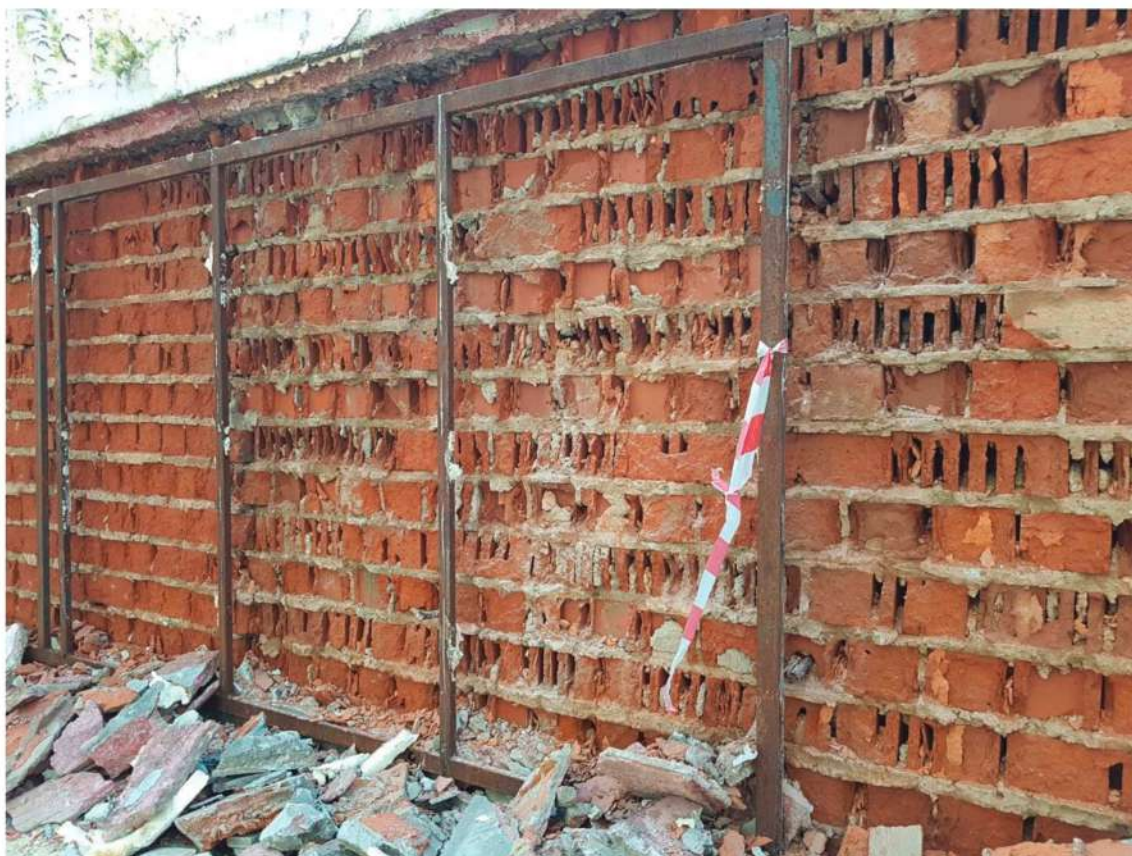
Фото 49. Отхождение лицевого слоя кирпича вместе с бухтящей штукатуркой.
