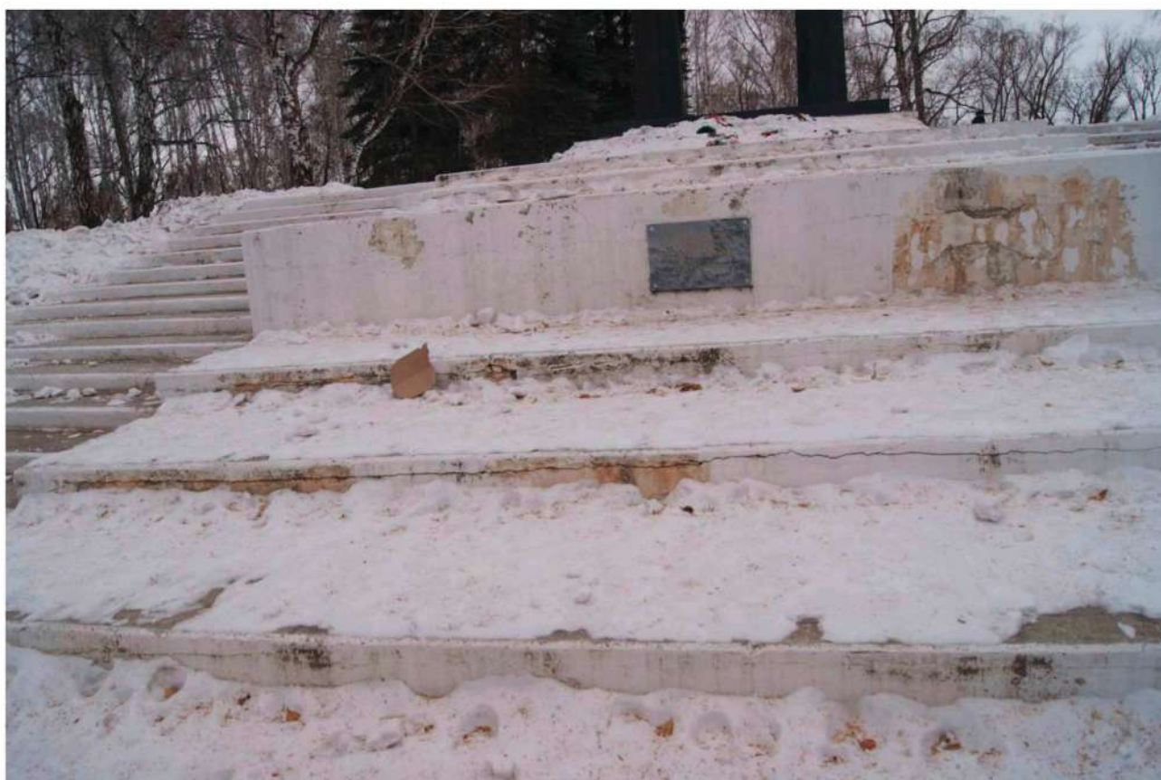
Фото 40. Вид на центральный лестничный марш с севера. Разрушение облицовочных слоев.
