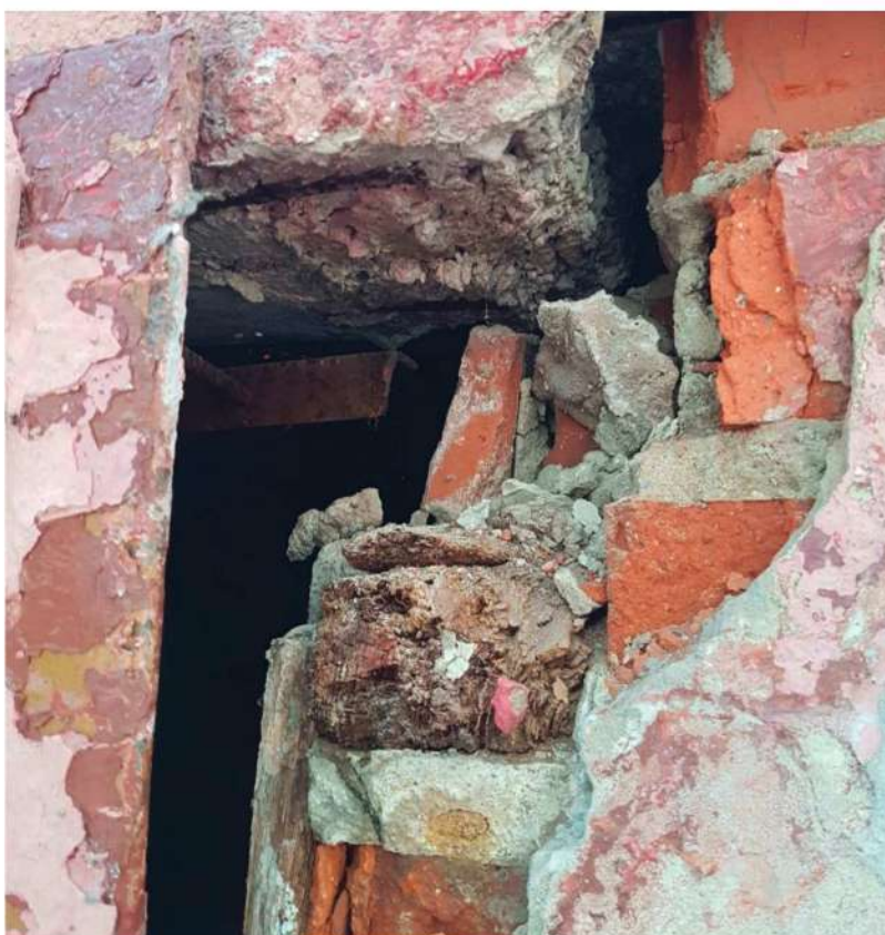
Фото 51. Разрушение опирания перемычки дверного проёма
