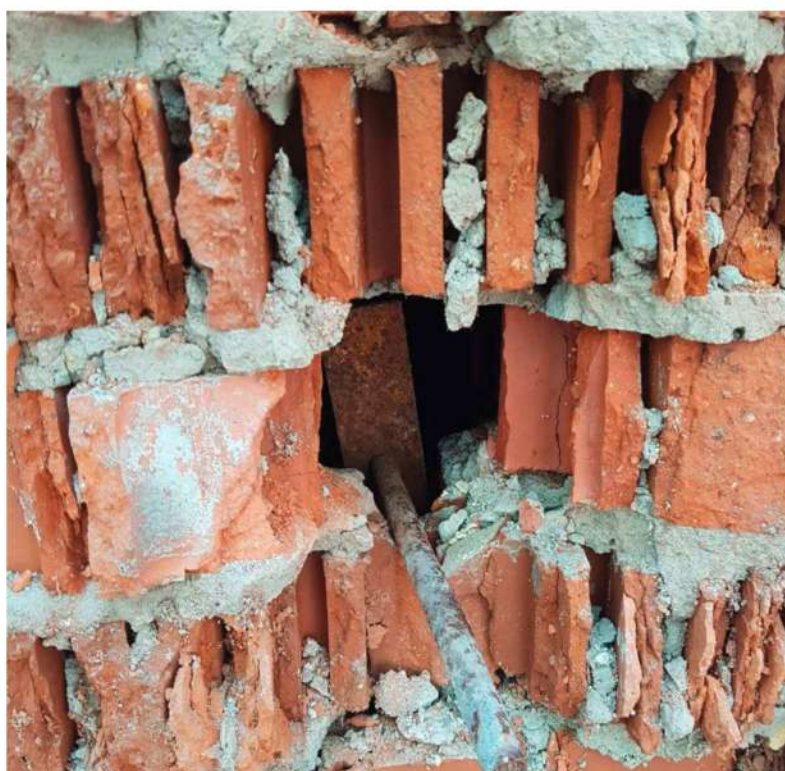
Фото 52. Сквозной пролом кирпичной кладки стены. Закладная деталь
