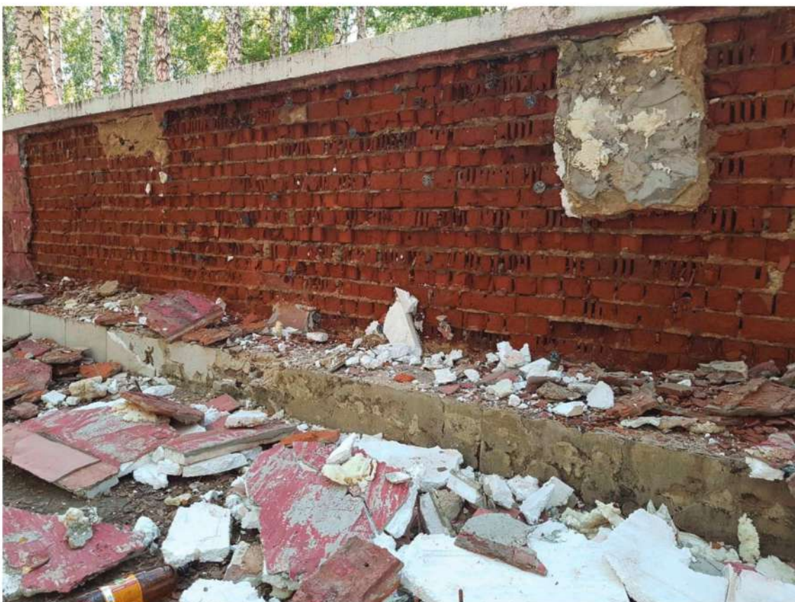
Фото 50. Повсеместное состояние кирпичной кладки. Деструкция кирпича
