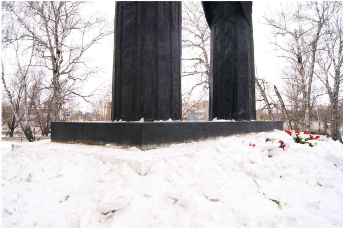
Фото 12 – Фрагмент нижней части скульптурной композиции с востока. Разрушение бетонного слоя основания постамента. Прорастание растительности
