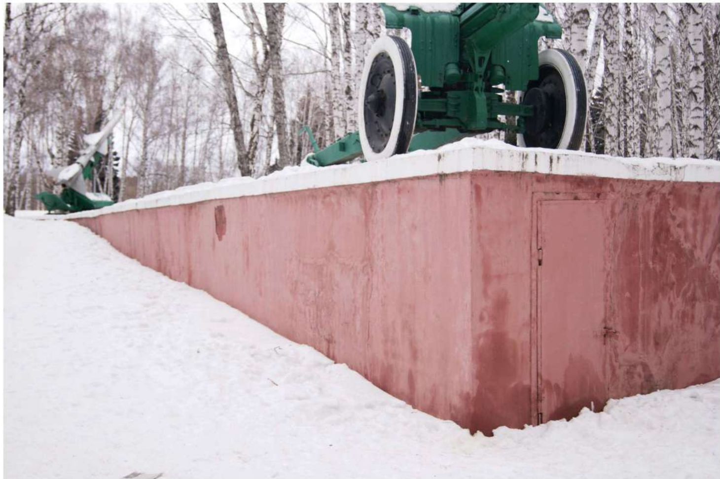
Фото 18 – Вид на внешнюю стену ограждения мемориала с юго-востока. Разрушение отделочного слоя
