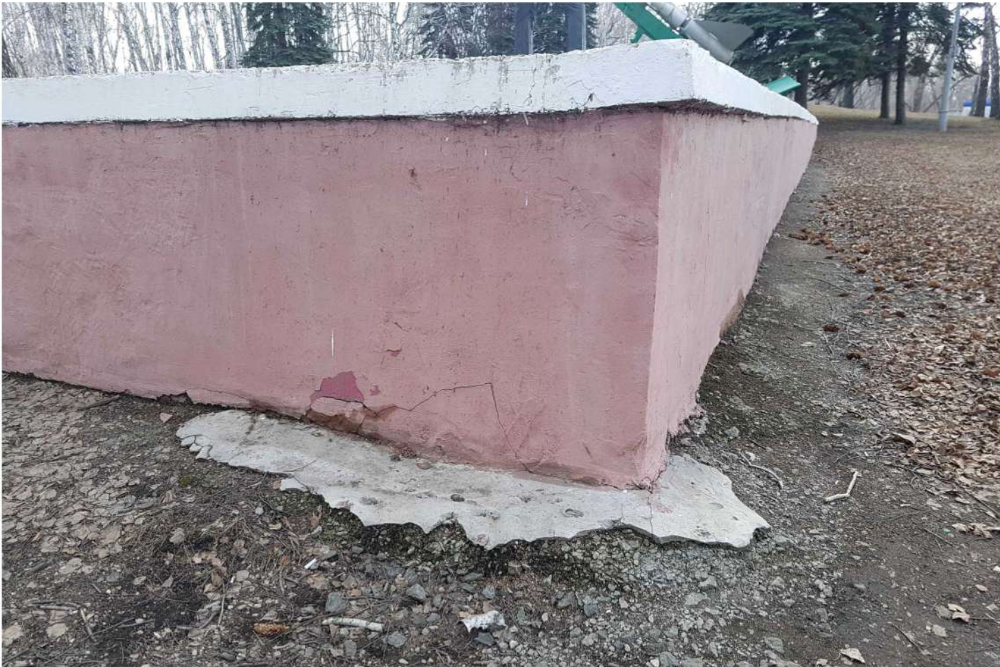
Фото 33 – Фрагмент ограждающей стены. Полное разрушение отмостки.
