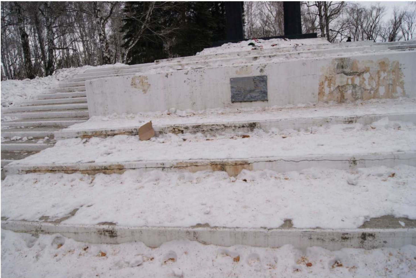
Фото 5 – Разрушение отделочного покрытия, сколы граней ступеней перед монументом
