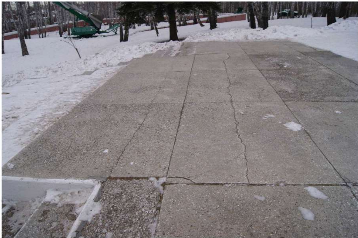
Фото 8 – Верхняя площадка перед монументом. Трещины и сколы углов и краев плит
