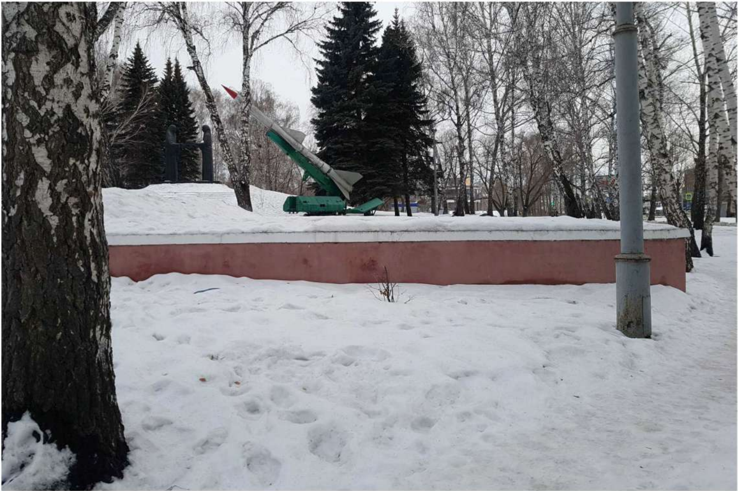
Фото 30 – Вид на внешнюю ограждающую стену с севера. Следы намокания на стене
