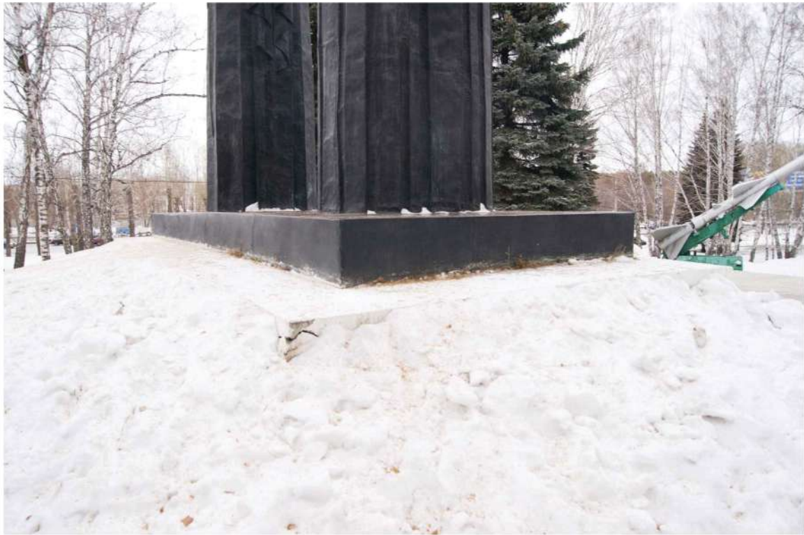
Фото 11 – Фрагмент нижней части скульптурной композиции с юго-востока. Разрушение бетонного слоя основания постамента. Прорастание растительности
