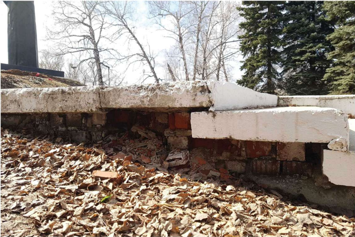
Фото 34 – Разрушение кирпичного основания под лестничным маршем
