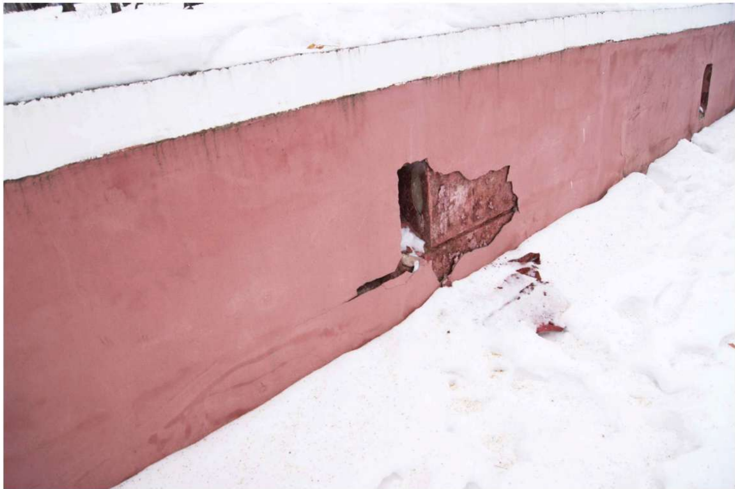
Фото 26 – Фрагмент ограждающей стены с внутренней стороны. Разрушение штукатурного слоя
