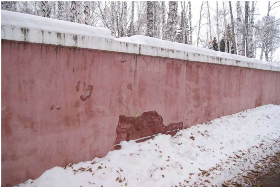
Фото 24 – Фрагмент внешней стены ограждения. Разрушение штукатурного слоя
