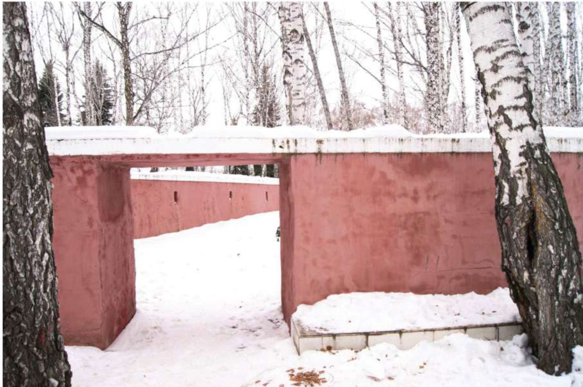
Фото 20 – Вид на проем внешней стены ограждения мемориала с востока. Разрушение отделочного слоя. Следы намокания
