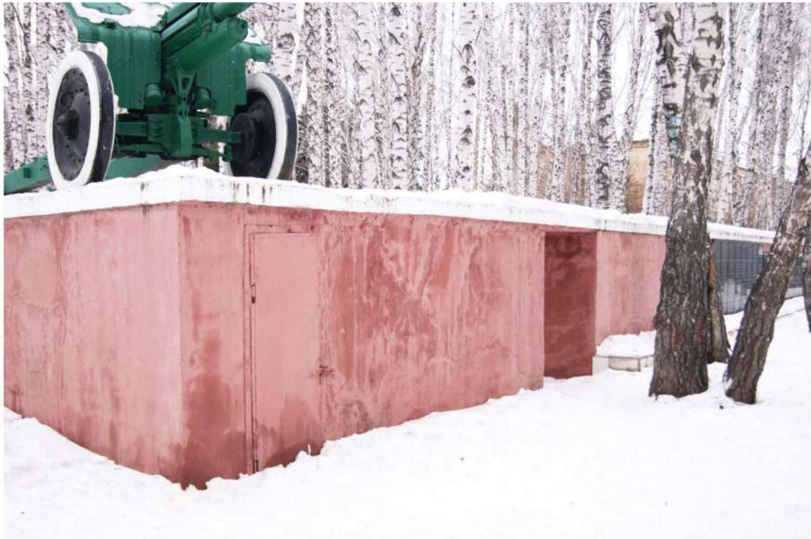
Фото 19 – Вид на внешнюю стену ограждения мемориала с юго-востока. Разрушение отделочного слоя. Следы намокания
