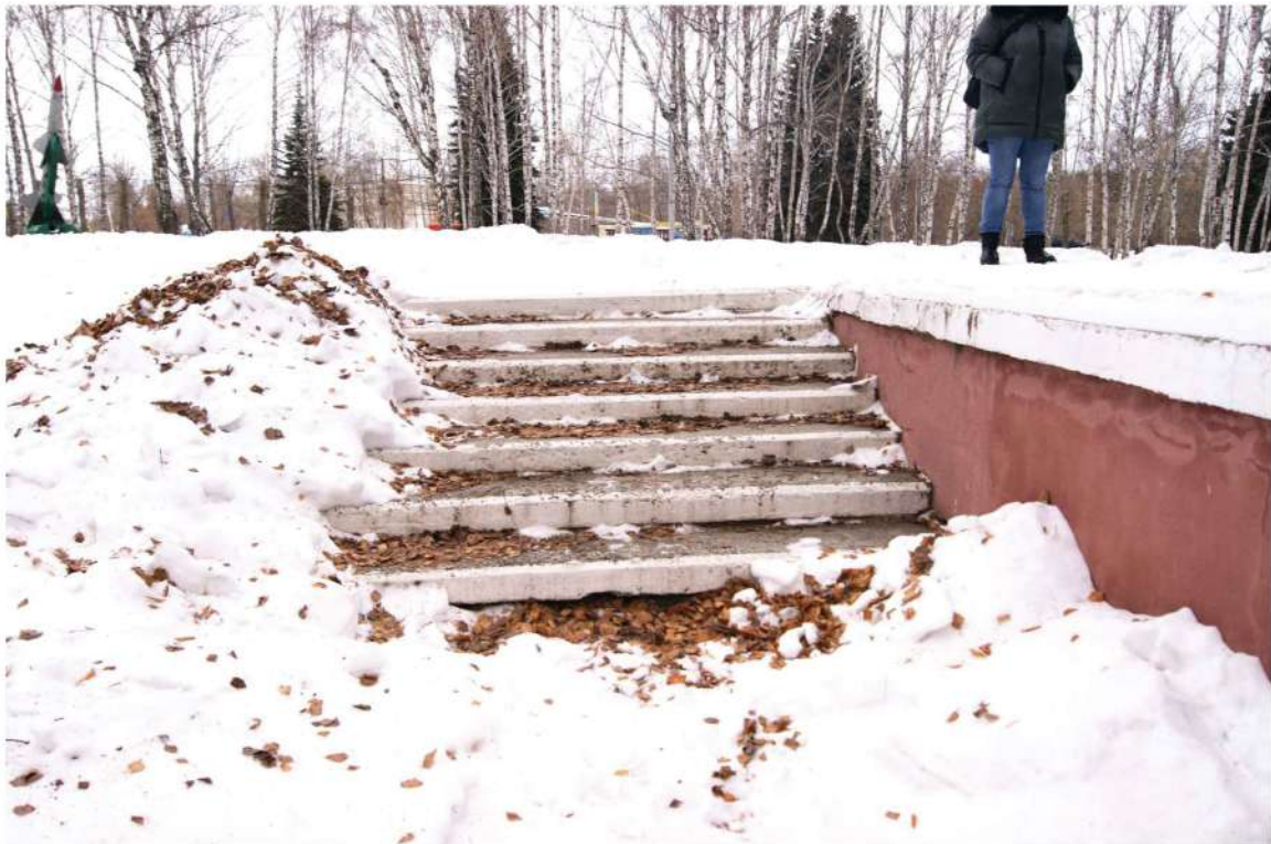
Фото 28 – Фрагмент лестничного марша. Просадка грунта под нижней ступенью
