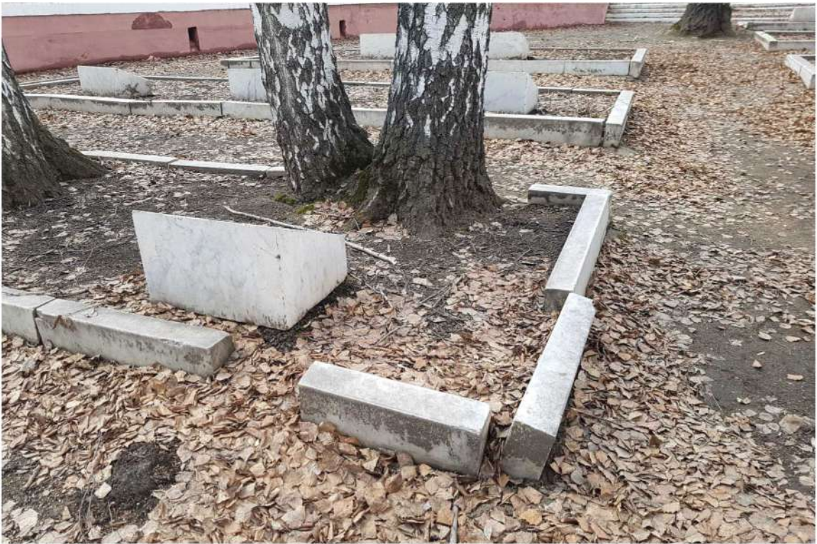
Фото 35 – Смещение бордюрного камня
