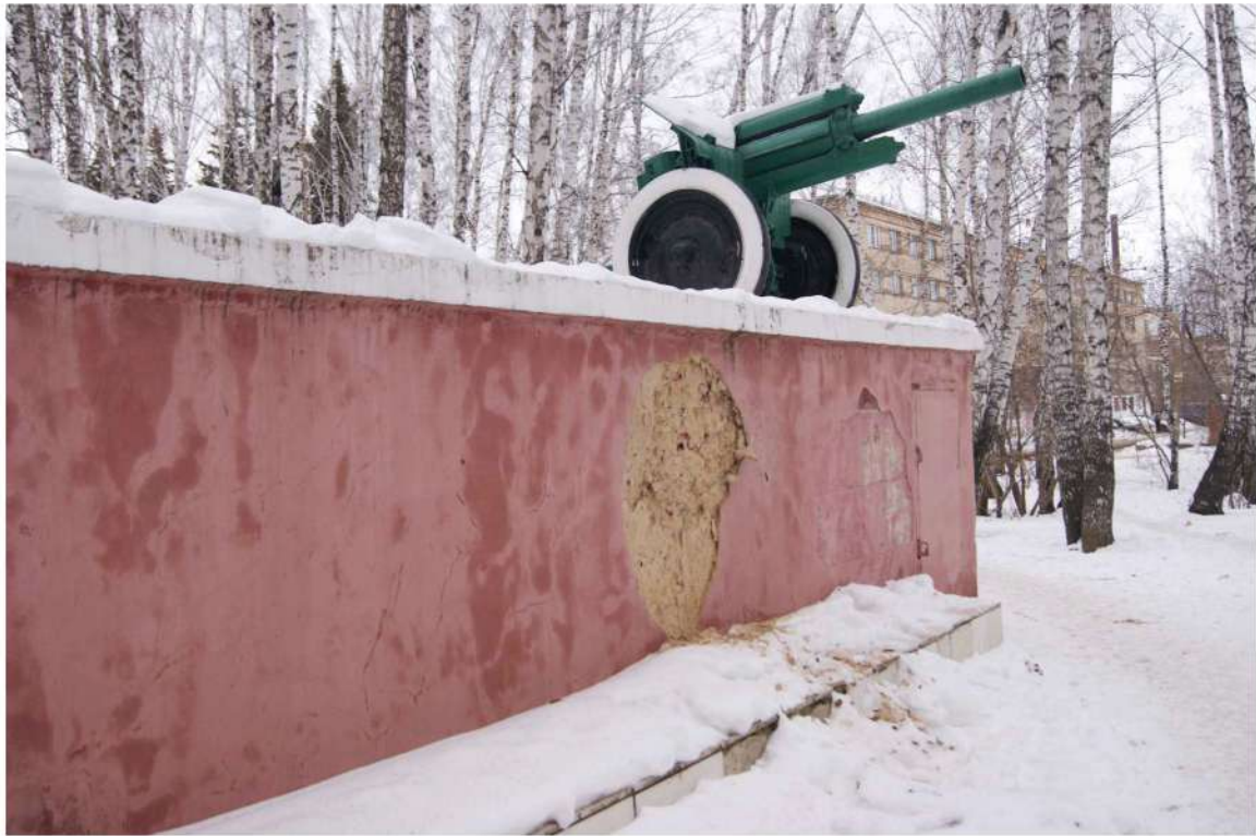
Фото 23 – Вид на внешнюю стену ограждения мемориала с юго-востока. Отслоение и обрушение участка штукатурного слоя
