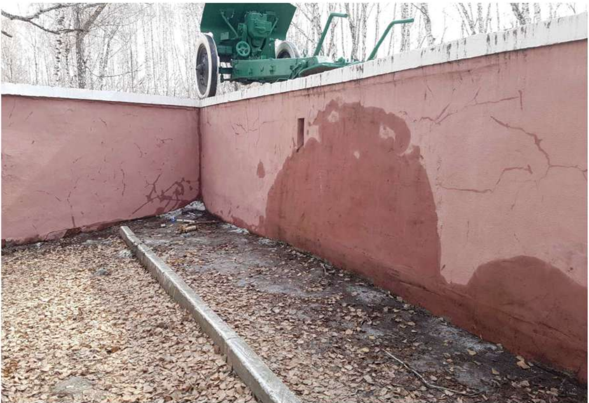
Фото 36 – Фрагмент ограждающей стены. Следы намокания
