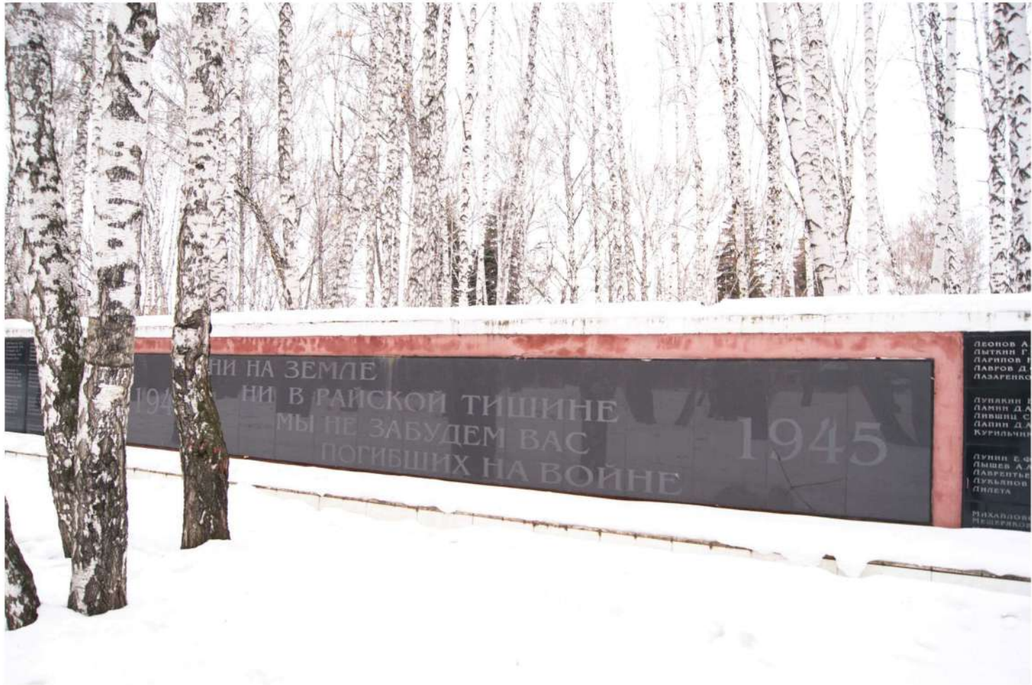
Фото 22 – Фрагмент ограждающей стены с внешней стороны. Трещины в мемориальных плитах
