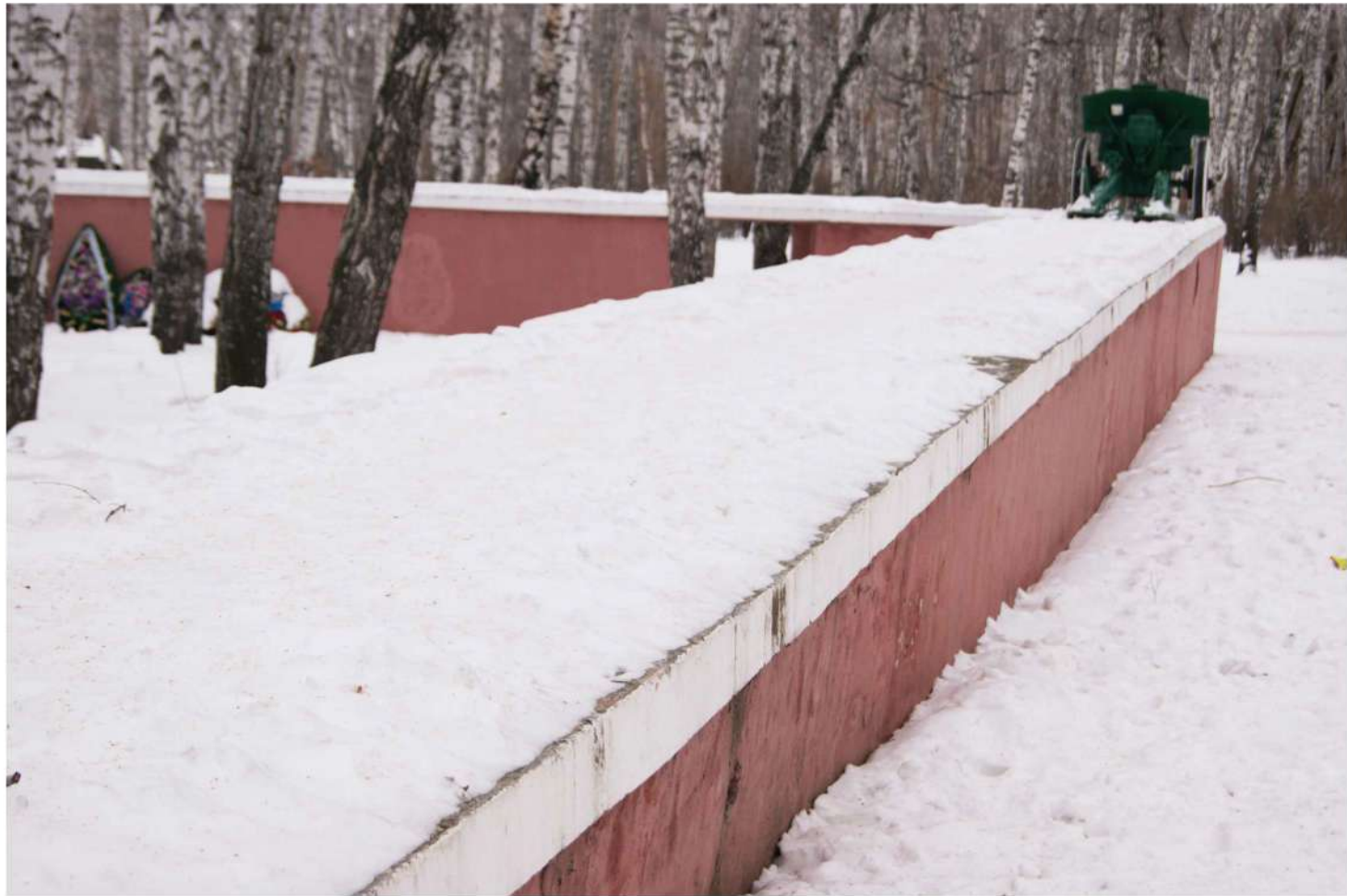
Фото 17 – Вид на внешнюю стену ограждения мемориала с запада. Разрушение отделочного слоя
