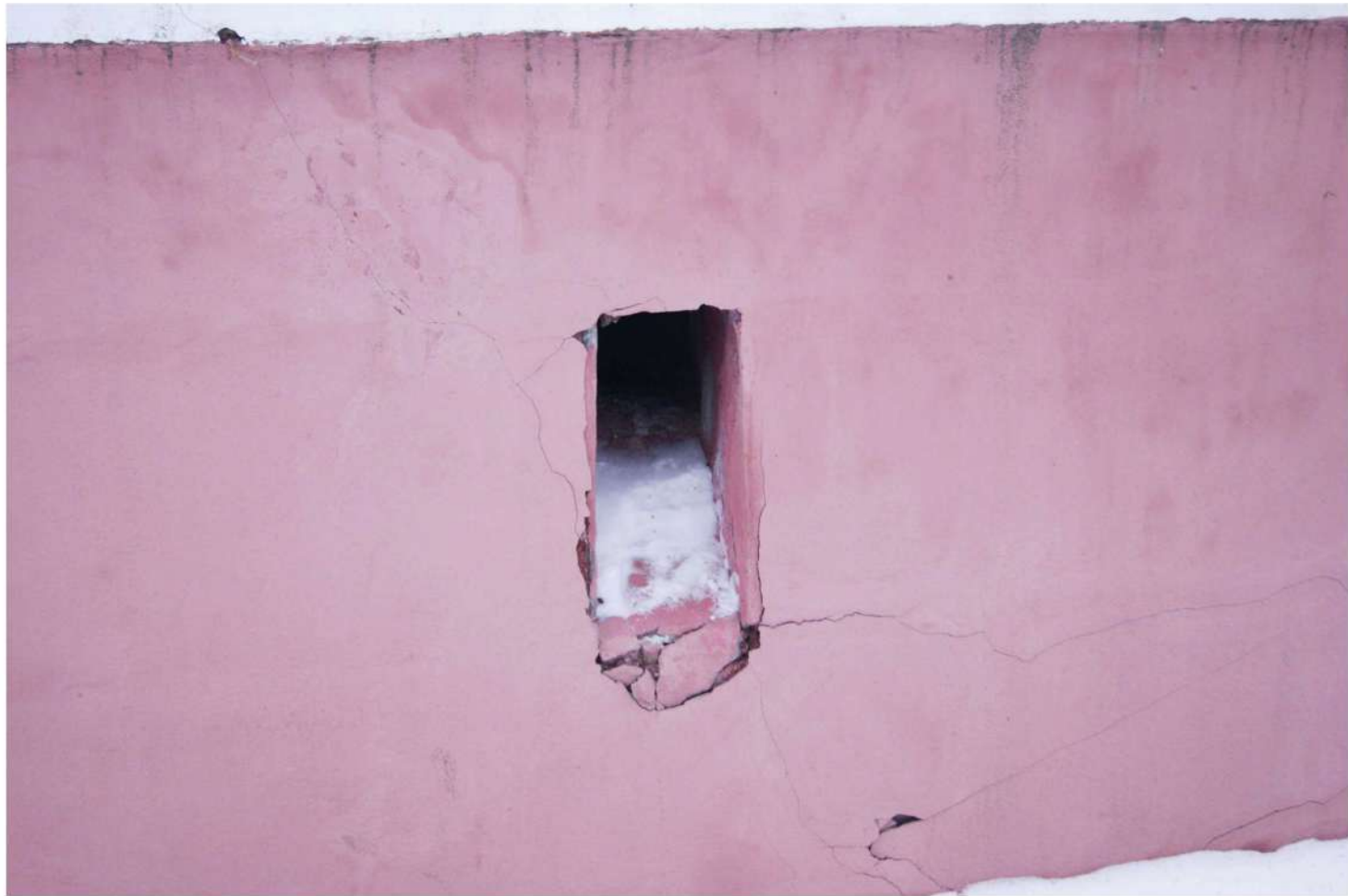
Фото 25 – Фрагмент ограждающей стены с внутренней стороны. Разрушение штукатурного слоя. Трещины
